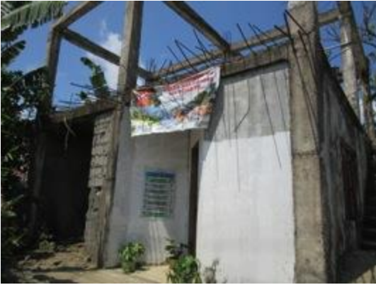
2) -①施設外観 建設中被害にあった
